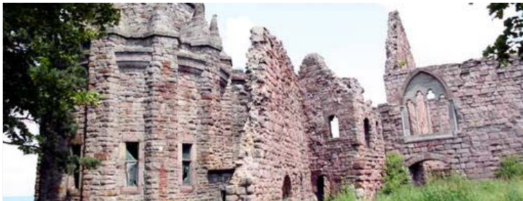
Die verfallene Rothenburg hat ihren Charme, das Areal mit seinen Bauruinen ist aber in einem bedauernswerten Zustand. Foto: Jacqueline Schulz
