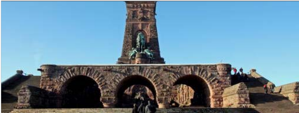
Die Sanierungsarbeiten am Kyffhäuser werden in diesem Jahr fortgesetzt. Foto: Jacqueline Schulz
